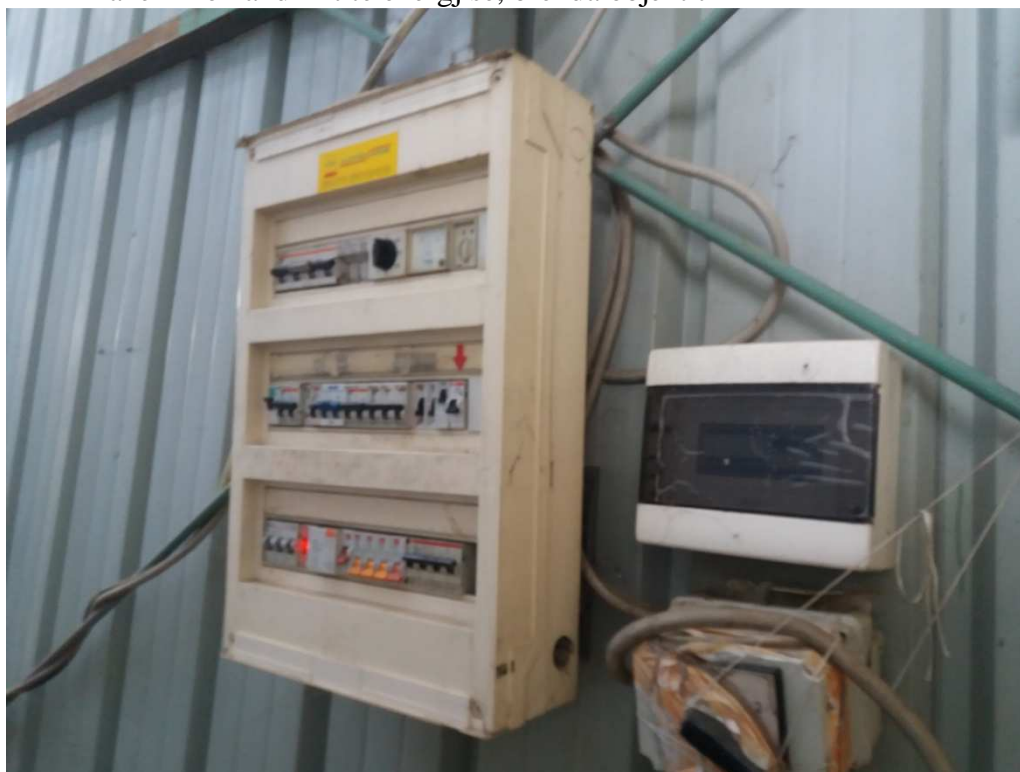
Panel I komandimit te energjise, brenda objektit
